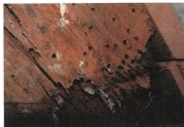
2.50 Ábra Nagy álszú ( Xestobium rufovillosum ) által okozott károsodás tetőgerendában
